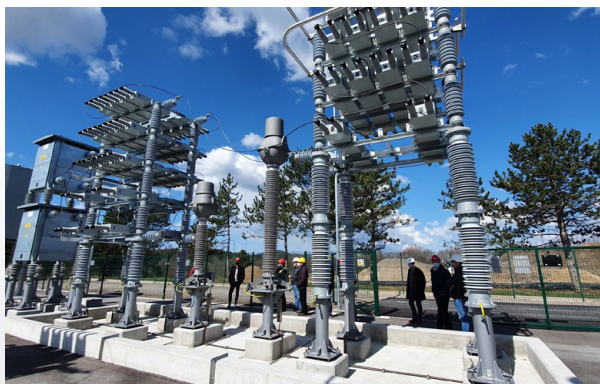
Vključitev energetskega kondenzatorja v RTP Divača
