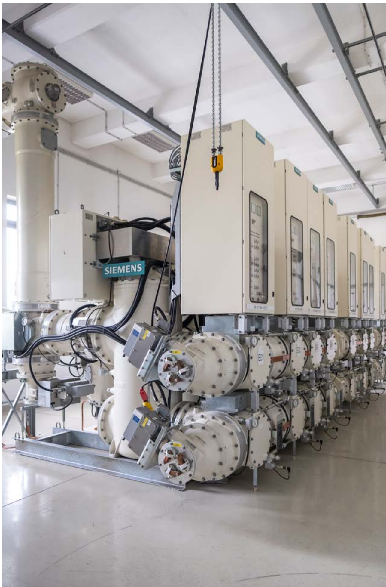
Senzorji in aktuatorji v 110 kV plinsko izoliranem stikališču
