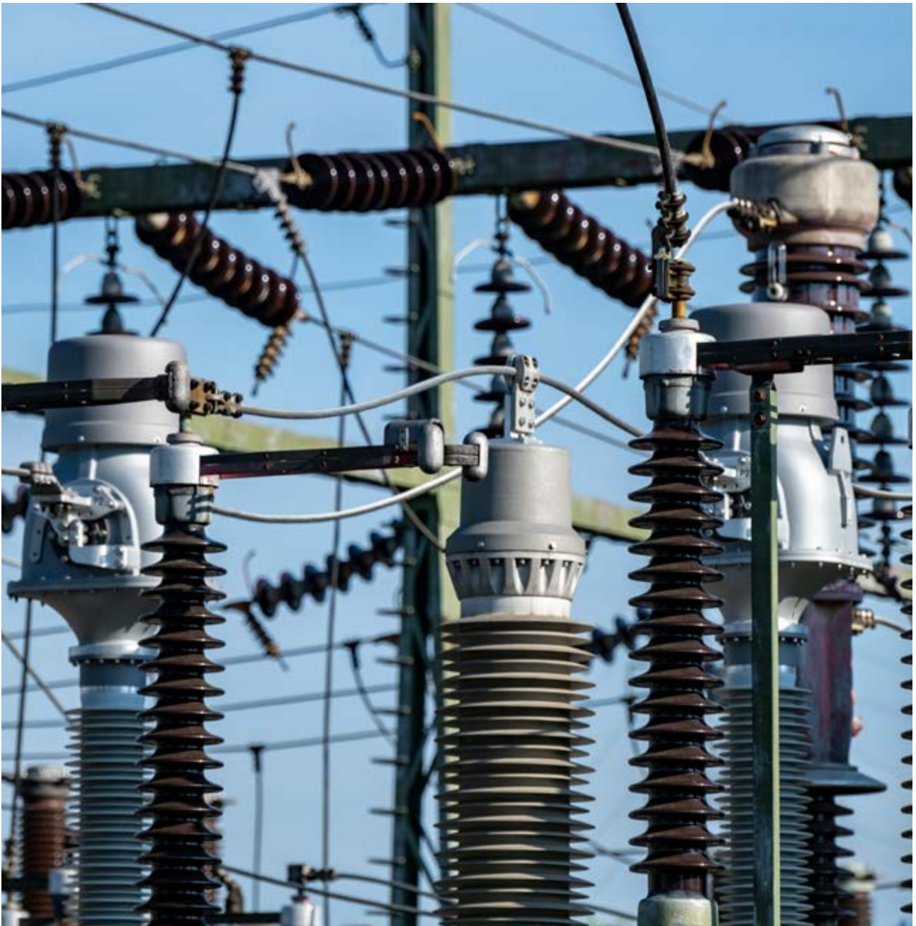
Oprema 110 kV stikališča (izrez)
