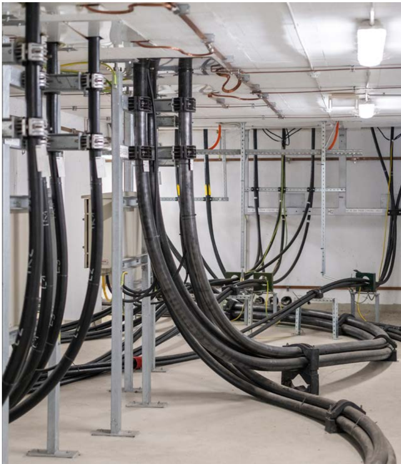
Kabelski prostor 110 kV stikališča
