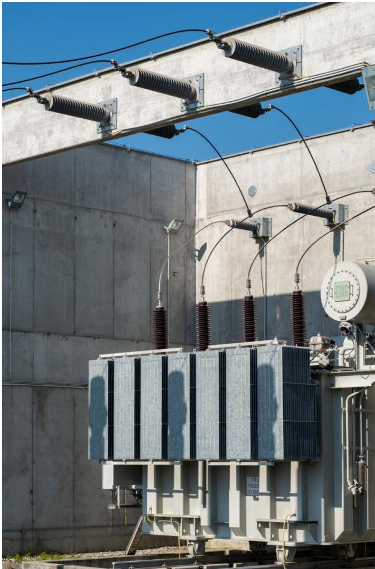
Energetski transformator 110/20 kV moči 31,5 MVA
