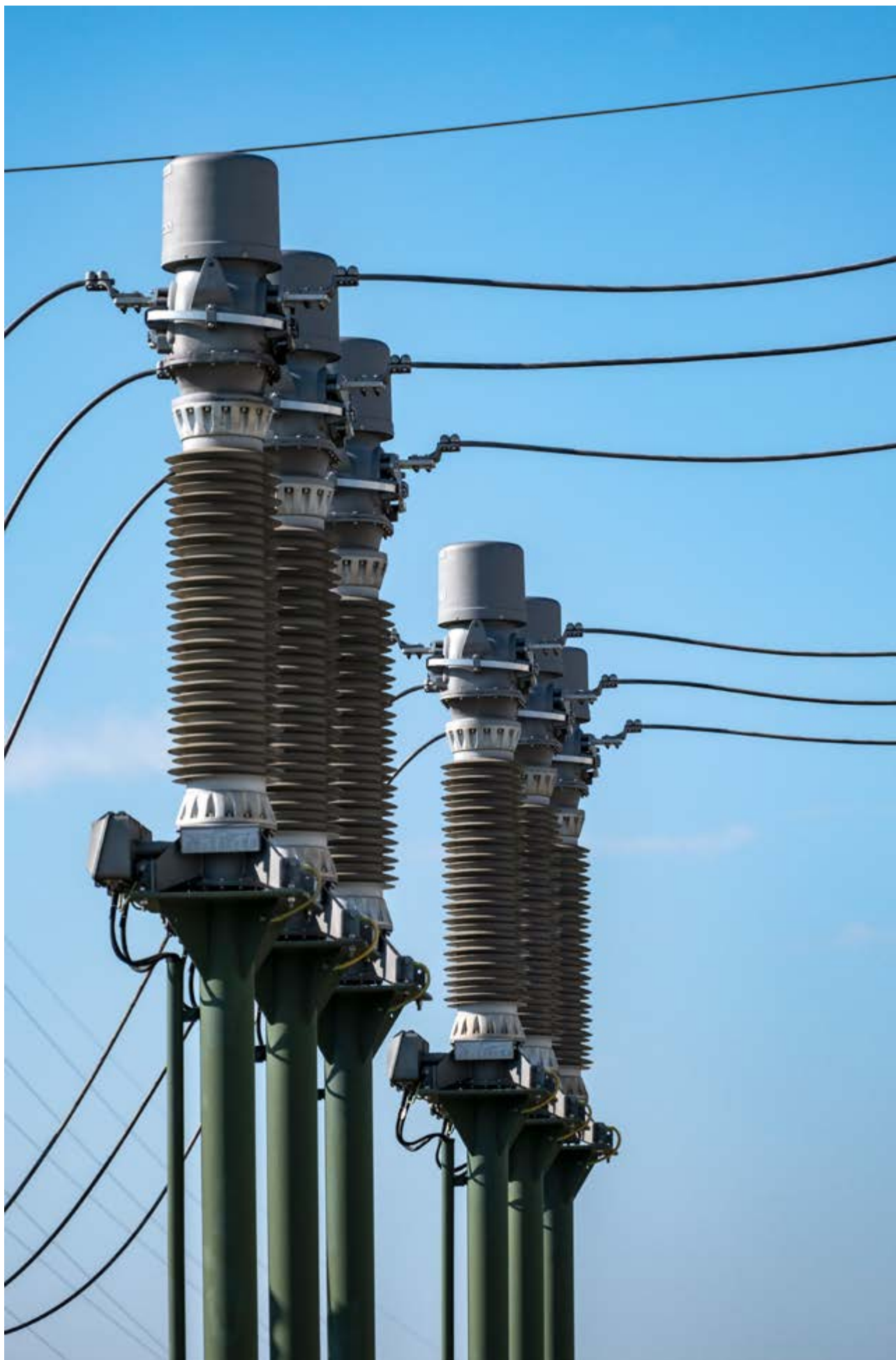
110 kV kombinirani instrumentni transformatorji v transformatorskem polju
