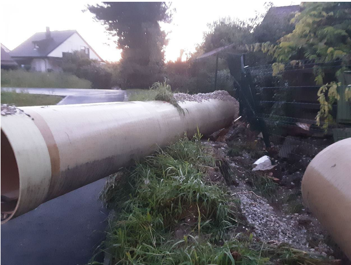
Slika 20. Cevi so bile sumljivo plitvo položene in taka vgradnja seveda ne zagotavlja ustrezne varnosti.
