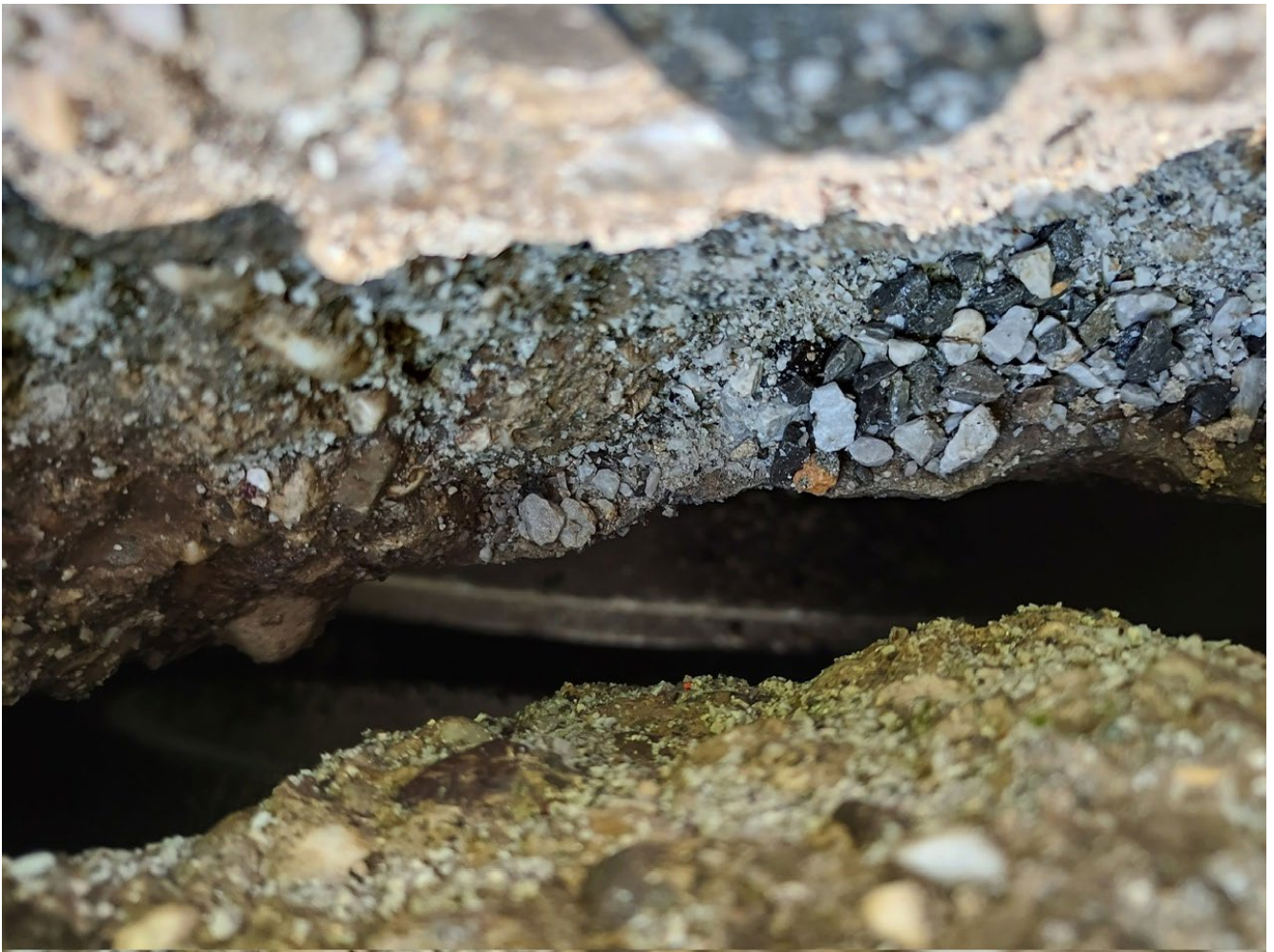
Slika 21. Črnuče skozi razpoko v stezi se vidi počen zaščitni beton in spoj cevi, kar dokazuje prmeike me dpoplavo. Neodvisna kontrola, projekta in posledic polave na Kanal CO mednarodnih strokovnjakov je nujno potrebna!
