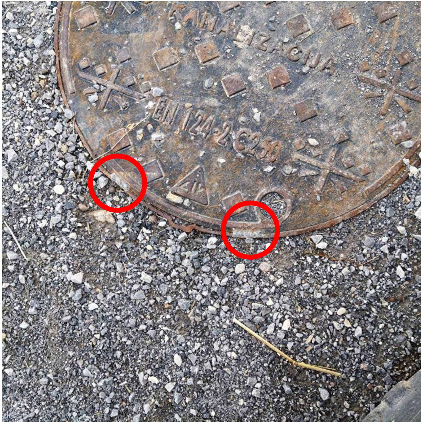
Slika 9. Zavarjen jašek, brez rež, ki ne omogoča odzračevanja metana.
